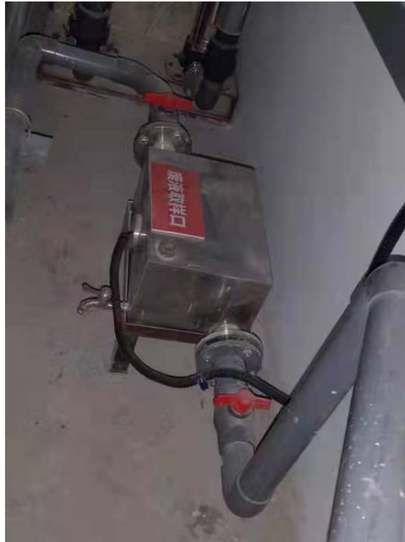
图 3-1 废液取样监测系统
