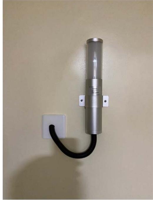
病房内固定式辐射监测仪探头
